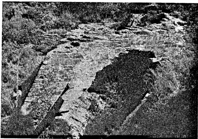
Guadramil ( Bragança ) — Muretes, na margem direita do ribeiro, para suporte de uma conduta de água para a Ferraria
